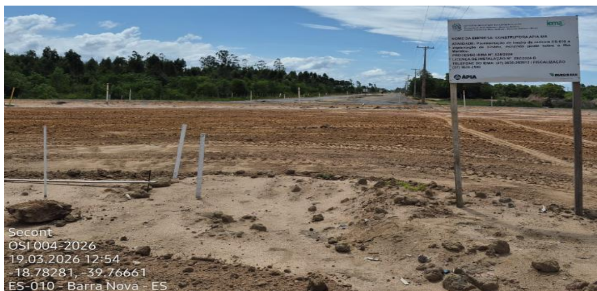
Figura 14: Linha de transmissão de alta tensão posicionada à direita da via
